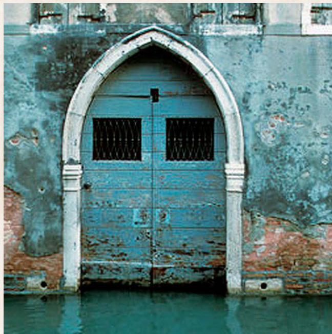
Typický príklad použitia vápenej omietky Rinzafo MGN v Benátkach: degradované, zasolené murivo v priamom kontakte s vodou
